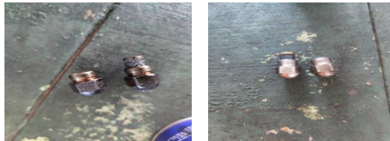
Gambar 3. Kondisi nozzle sebelum (kiri) dan sesudah (kanan) dibersihkan
