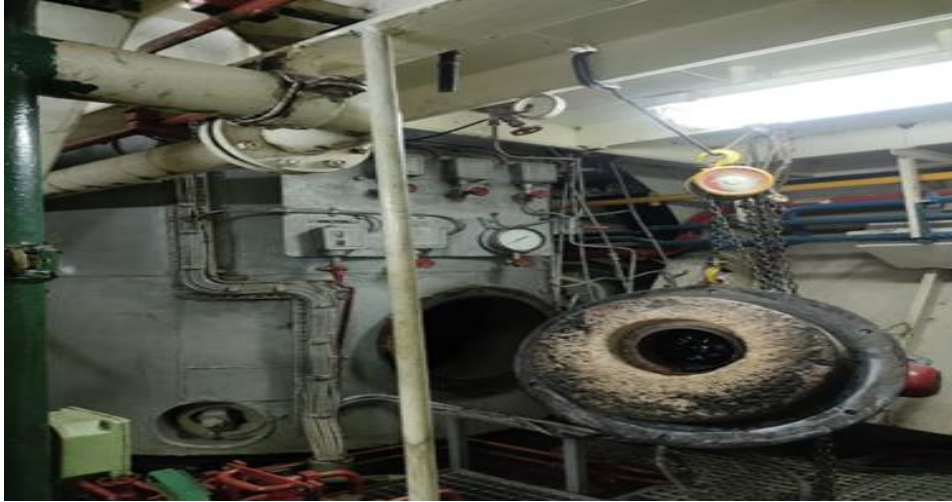
Gambar 1. Boiler di KM. Binaiya
